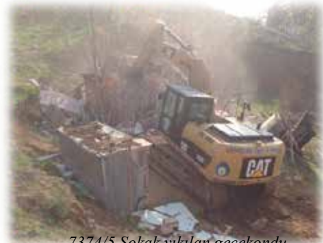
7374/5 Sokak yıkılan gecekondur
